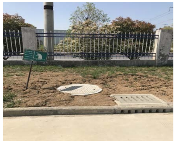
厂区污水总排口
